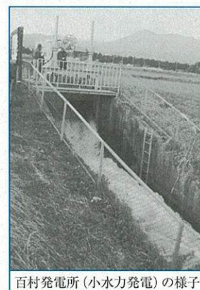
百村発電所（小水力発電）の様子
